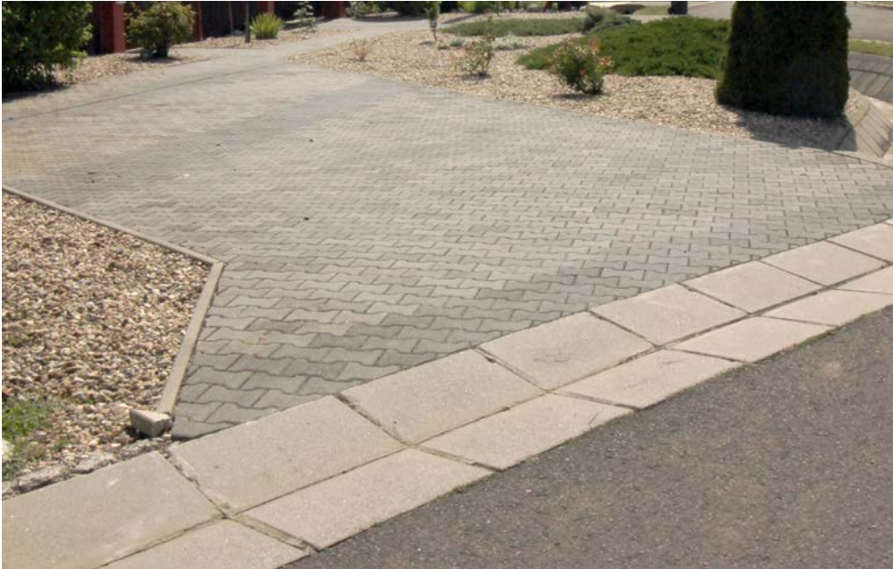
[101] A TÚLZOTT BURKOLÁS, A CSAPADÉKVÍZ ELVEZETÉSE ÉS A KAVICSTERÍTÉS FELBORÍTJA A TALAJ TERMÉSZETES VÍZHÁZTARTÁSÁT fotó: Tunnel Kft.
